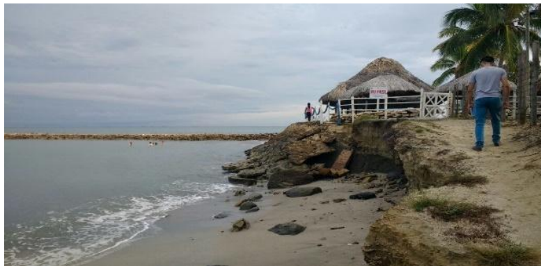
Figura 3. Sector de playa erosionado. Fuente: grupo de trabajo, 2021.
